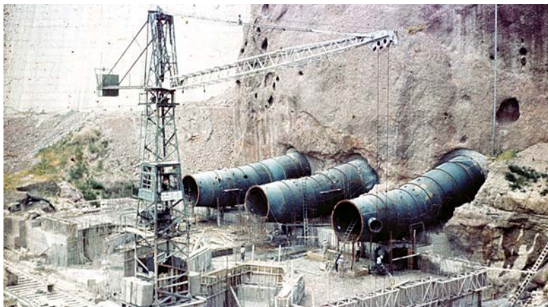
TUBERÍAS. EN UN PRINCIPIO SE PENSABAN COLOCAR TRES TURBINAS. ESTAS TUBERÍAS CONDUCE EL AGUA DENTRO DE LA CENTRAL PARA GENERAR ENERGÍA ELÉCTRICA.
