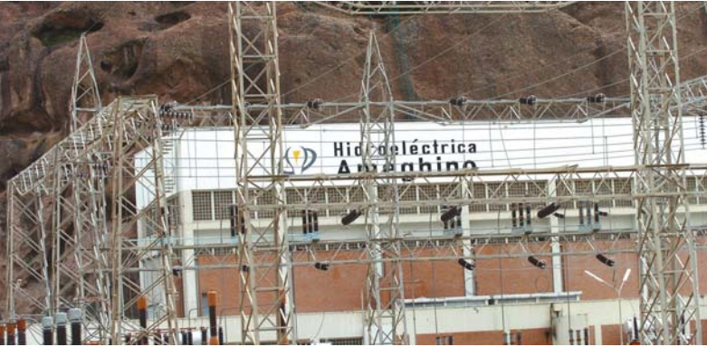
ESTACIÓN TRANSFORMADORA. DETRÁS, EL EDIFICIO DE HASA
